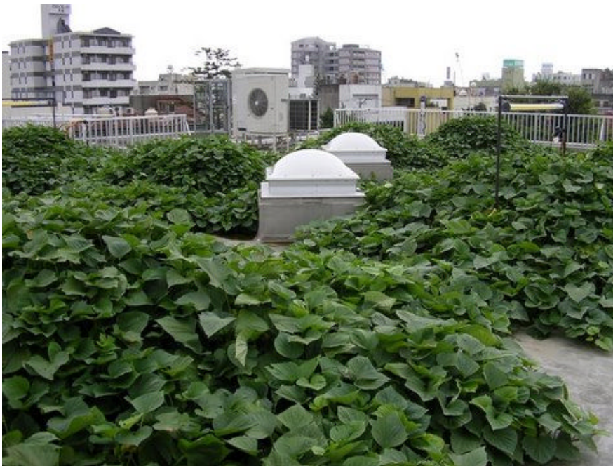
屋上に繁茂したサツマイモの状態
