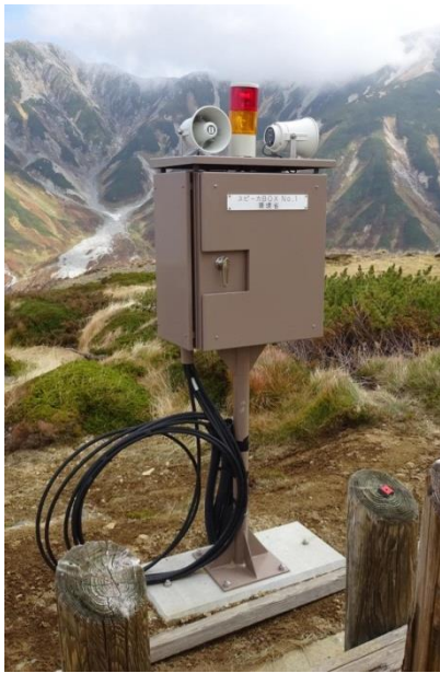
火山ガス検知器
