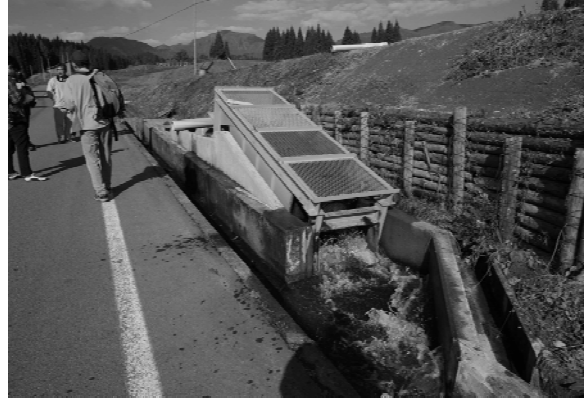
水力発電装置
