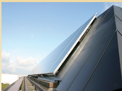
太陽光発電(安城市)
