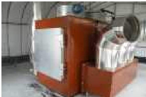
木質バイオマス利用加温設備
