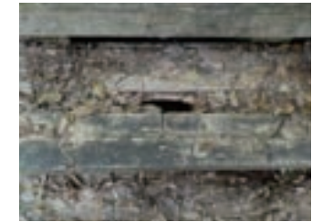
天端板の破損・老朽化
