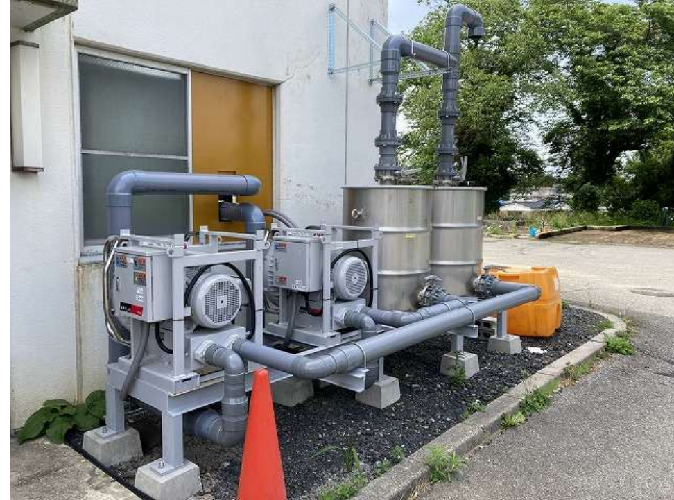
仮設脱臭設備
