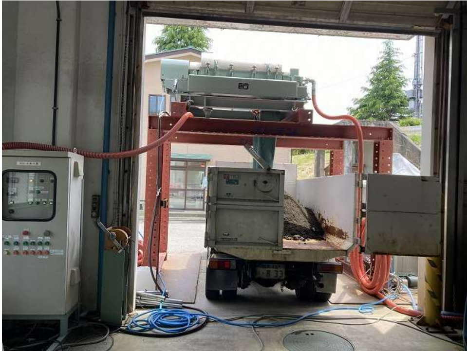
仮設脱水設備
