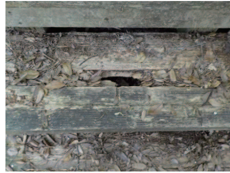
天端板の破損・老朽化
