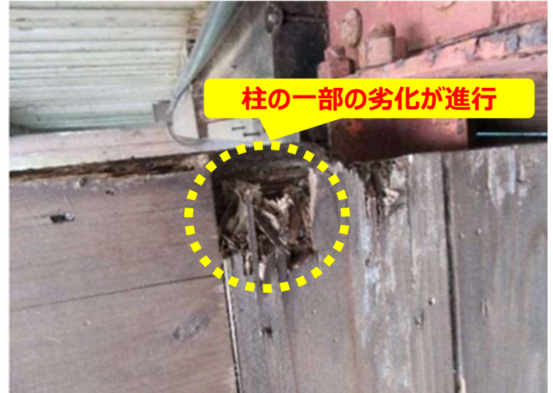
横山展望台スロープデッキの劣化状況
