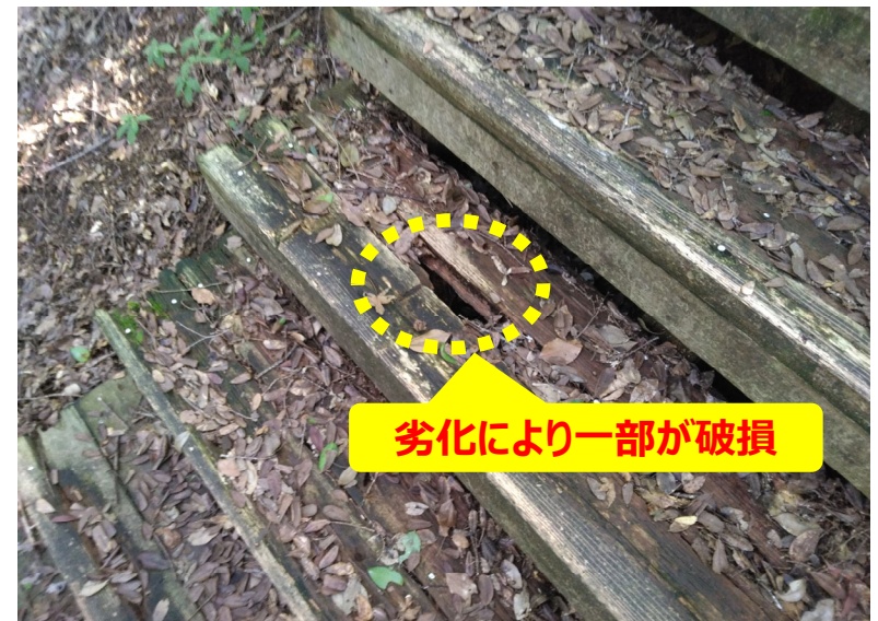
木道（階段）の劣化状況
