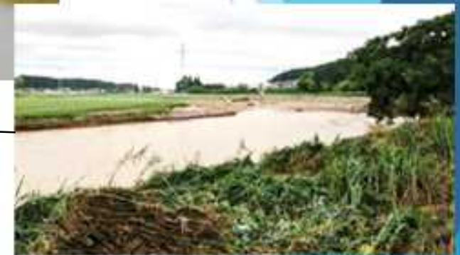
堤防決壊（上八里町地区）
