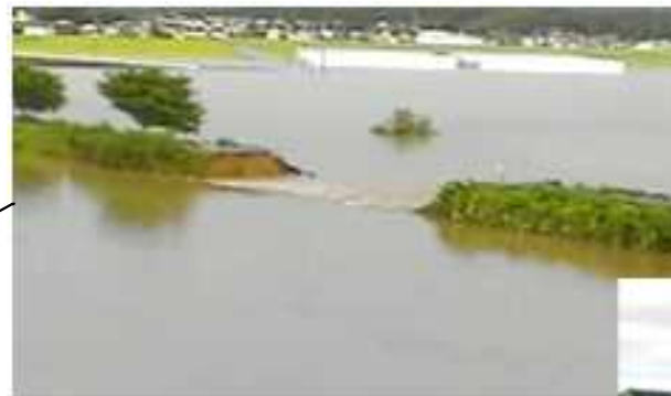
堤防決壊（古府町地区）
