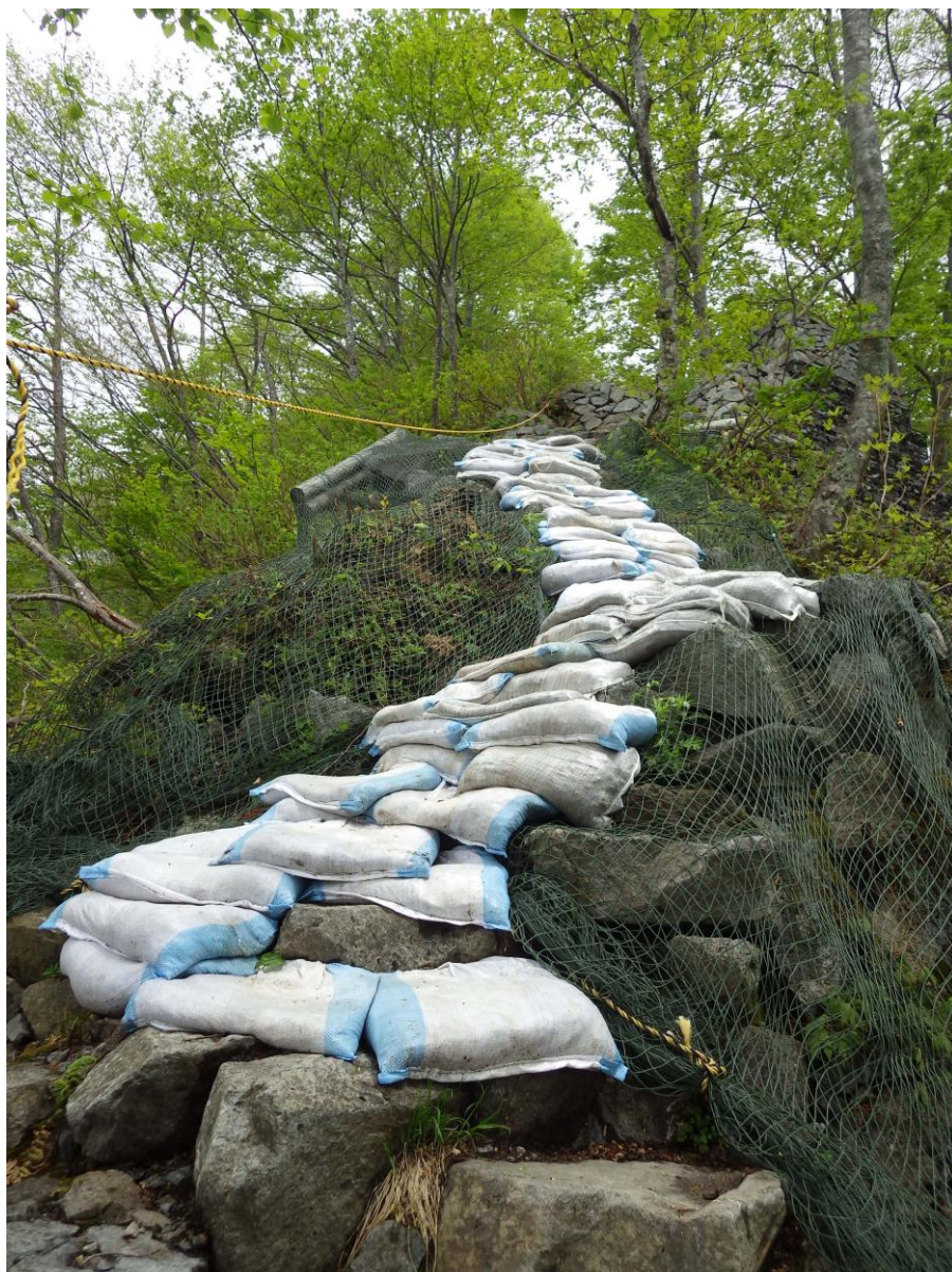
【崩落地応急復旧の実施状況写真】
