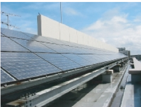
太陽光発電設備
