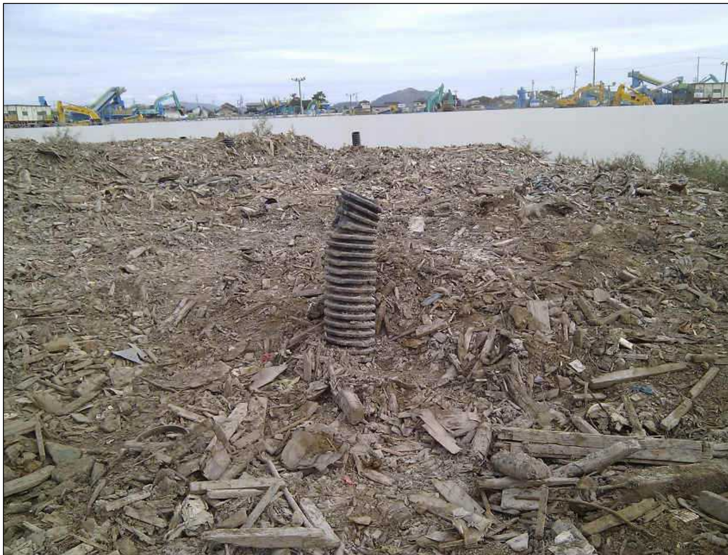
※火災防止のためのガス抜き管
