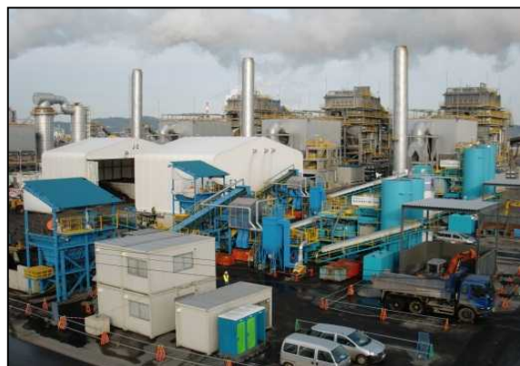
焼却灰造粒 固化設備 (石巻ブロックの例)
