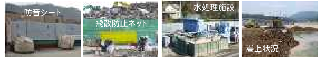
周辺環境対策の事例
