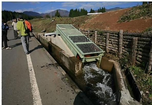
水力発電装置
