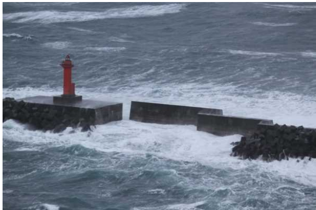
高波による防波堤の被災例
