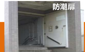
地下鉄出入口の浸水対策
