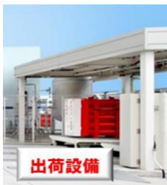
水素供給施設
