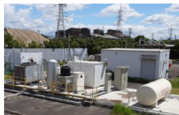
水素供給設備例
