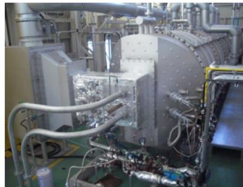
アンモニア燃焼試験設備（0.5トン／時燃焼試験炉） 出典：三菱重工プレスリリース ( https://www.mhi.com/jp/news/23112801.html )
