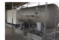
バッファタンク
