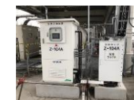
水素充填ユニット
