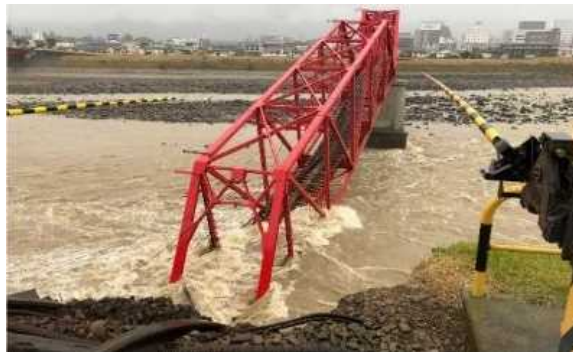
長野県上田市 橋梁が倒壊し、鉄道が不通となった。 （画像：国土交通省）
