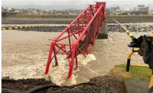
長野県上田市（画像：国土交通省） 橋梁が倒壊し、鉄道が不通となりました。
